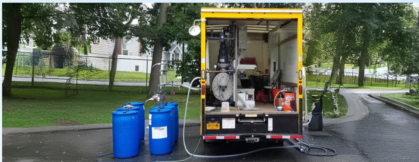
Figura 15: un sistema mobile UV AOP utilizzato per test pilota e delle prestazioni in loco.
