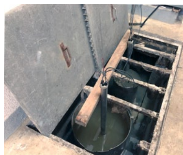
Due sensori Hach per H 2 S hanno monitorato costantemente l'H 2 S disciolto nelle acque di scarico non depurate ai due ingressi dell'impianto di trattamento acque reflue di Cassis.
