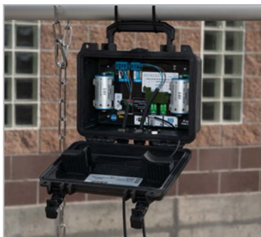
Transmetteur de terrain et câblage
