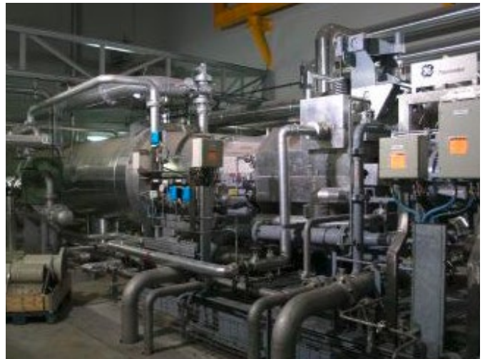
Turbine à vapeur dans une station d'incinération
