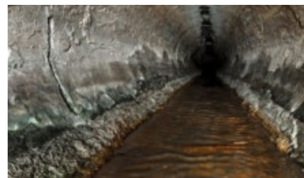
Figur 3. Svavelsyra som attackerar karbonat i hårdade betongrör äventyrar deras kapacitet som bindemedel, förvandlar solida rörväggar till flagigt gips och korroderar de inbäddade armeringsjärnen.
