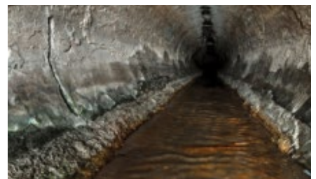
รูปที่ 3 กรดซัลฟิวริกที่ก่อกองคาร์บอนไดออกไซด์ในท่อคอนกรีตที่แข็งตัวแล้วจะทำให้ความสามารถในการยึดเกาะลดลง เปลี่ยนผนังท่อที่เป็นของแข็งให้เป็นยิปซัมที่เป็นสะเก็ด และก่อกองเหล็กเสริมที่ฝังอยู่
