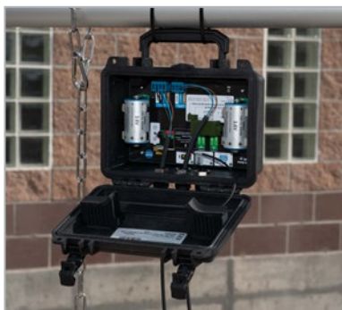
Veldtransmitter en bekabeling
