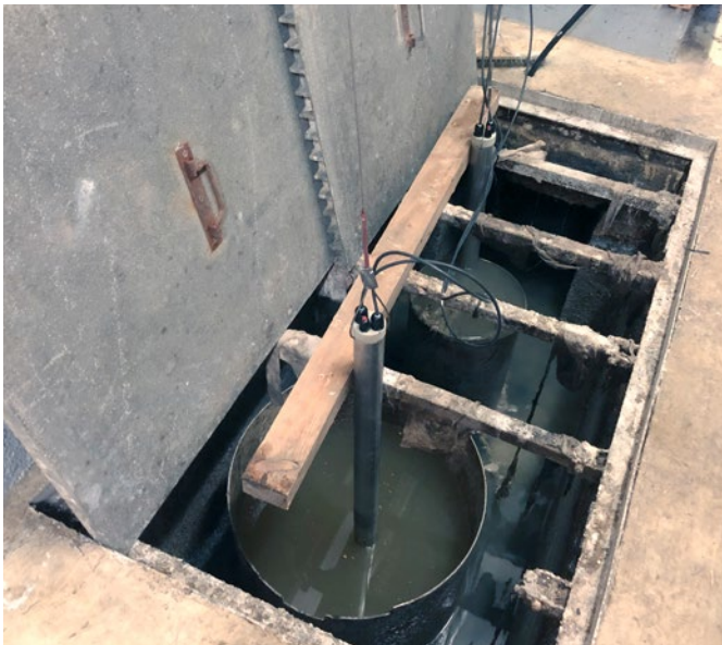
รูปที่ 3 ความยืดหยุ่นในการติดตั้งเซ็นเซอร์แบบสองเฟสอย่างถาวรหรือแบบชั่วคราวในน้ำเสียโดยตรงหรือในอากาศเหนือน้ำเสีย จะช่วยให้ผู้ควบคุมระบบบำบัดน้ำเสียมีข้อมูลในการตรวจหาปัญหาที่เกี่ยวกับกลิ่นที่อาจเกิดขึ้น ซึ่งจะส่งผลต่อความปลอดภัยหรือปัญหาด้านกระบวนการบำบัดในโรงงาน
