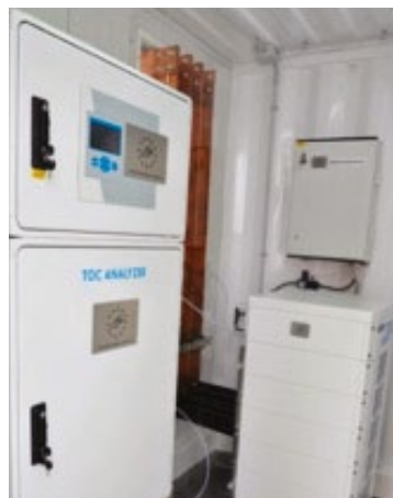
Afbeelding 3: de op de locatie geïnstalleerde BioTector B7000
