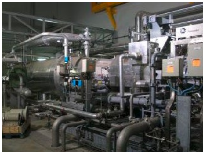
Parní turbína ve spalovně
