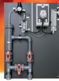
Panel de pre-acondicionamiento de muestras
