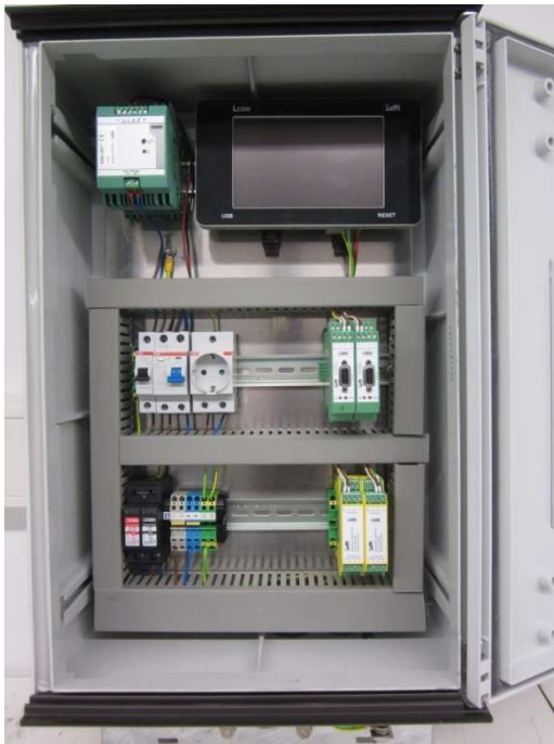
Abbildung 6: Beispiel eines Standard Lufft UMB-Schaltschranks
